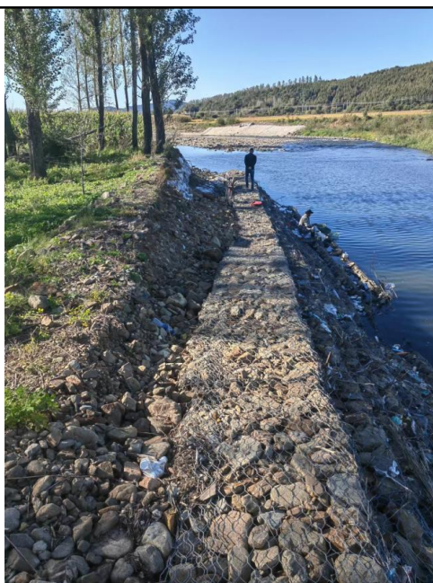
图 2-8 护岸 2 下沉严重
