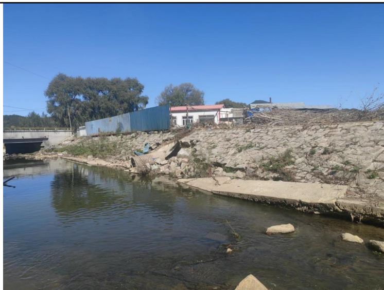
图 2-6 右岸 1-2 现状固脚悬空下沉，浆砌石护坡破损塌陷
