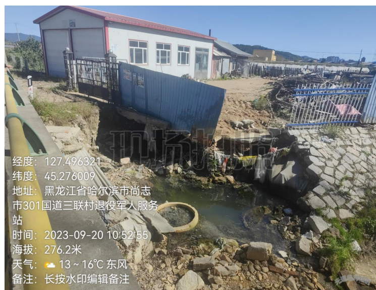
图 2-7 右岸 1-3 岸坡塌陷，明显退岸
