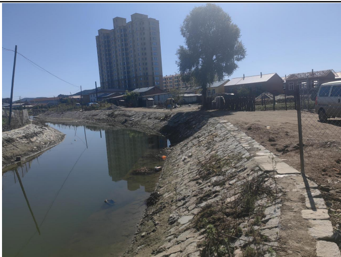
图 2-2 左岸 1-2 封顶破损
