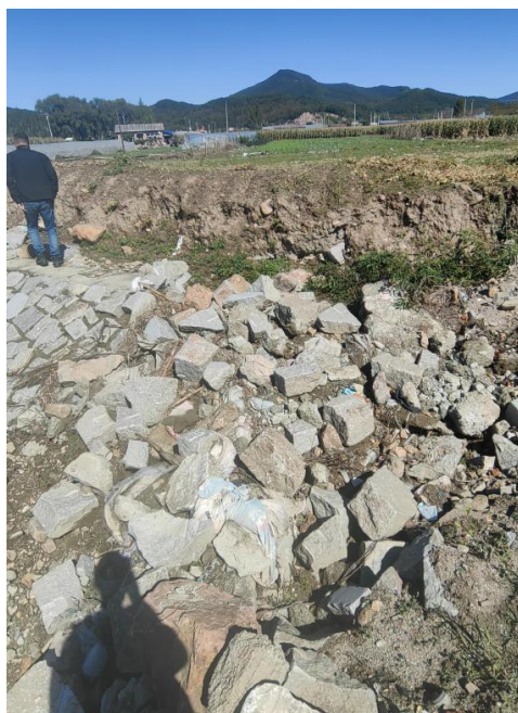
图 2-5 右岸 1-1 砌石散乱严重
