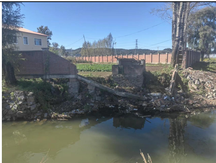
图 2-4 左岸 1-5 现状岸坡淘刷严重
