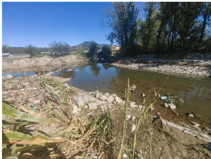
图 2-3 左岸 1-4 现状浆砌石护砌破损
